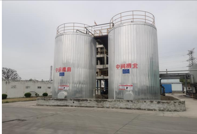
甲醛中间储罐
