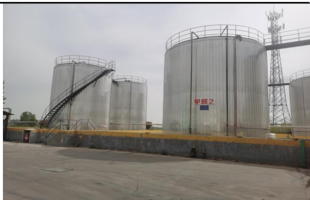
甲醛成品储罐
